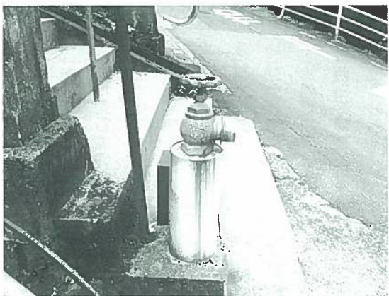
初期消火に威力を発揮する消化栓
