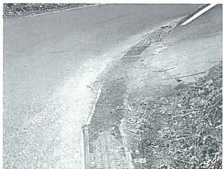
土砂詰まりの側溝
