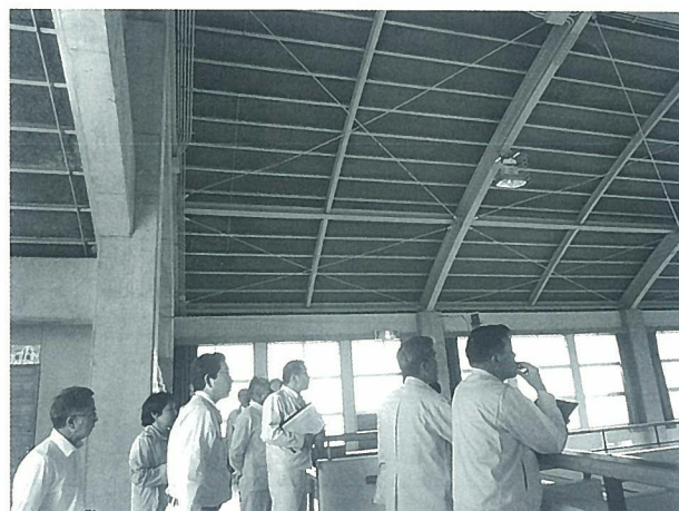
中学校体育館の地震災害調査
