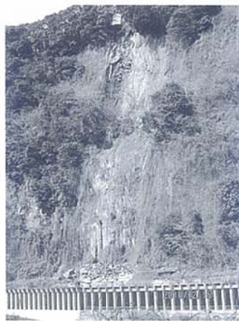
(復旧が待たれる西日之影崩落現場)
