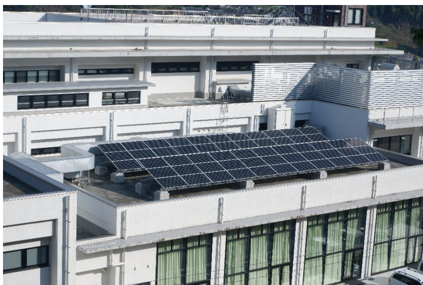
図5 本庁舎における太陽光発電設備（出典：日之影町資料）
