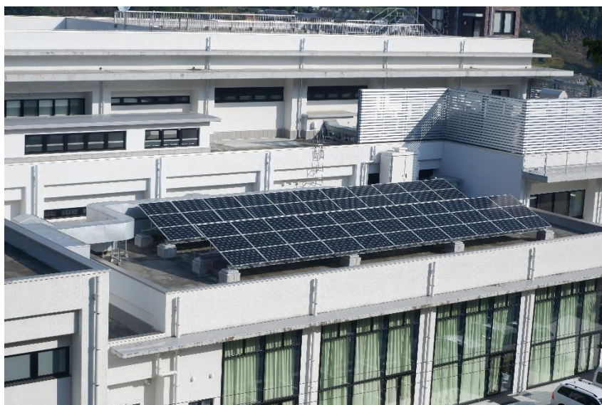
図6-5 本庁舎における太陽光発電設備
