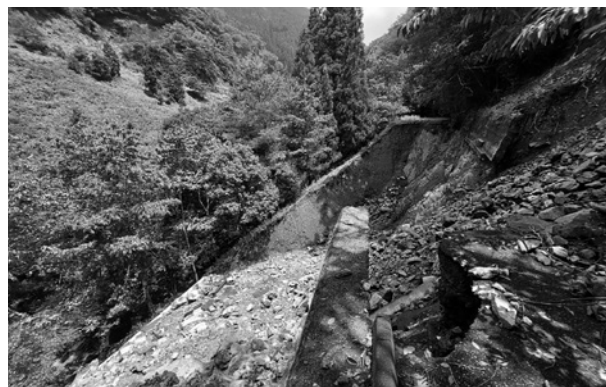
【被災直後の状況】
