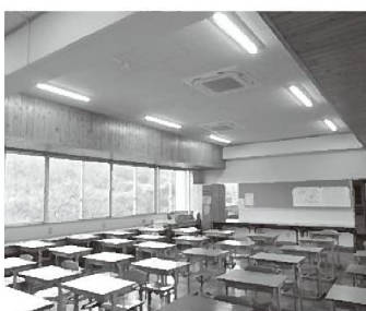
LED化終了後の教室
